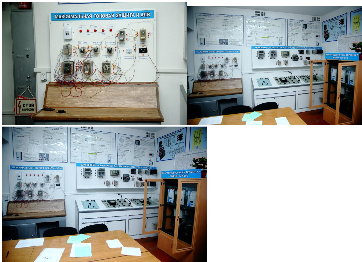
Аудитория 5/104. Лаборатория «Релейная защита и автоматизация ЭЭС
